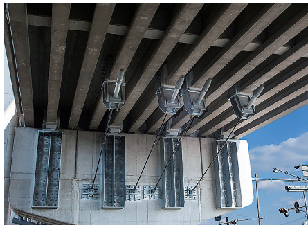
落橋防止装置
