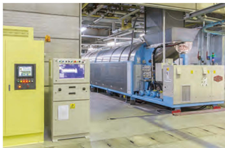
大型連続洗濯機
