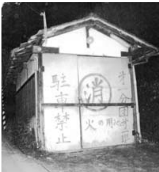
老朽化した消防器具庫
