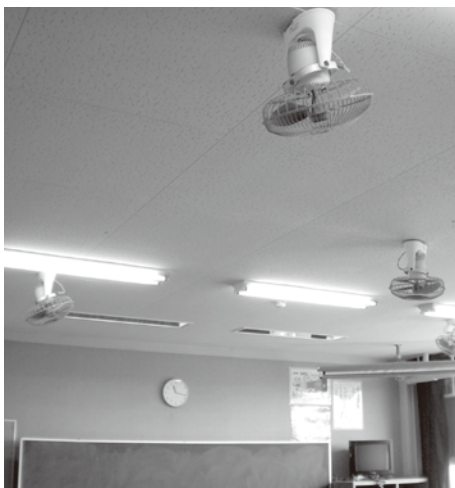
教室に設置された扇風機
