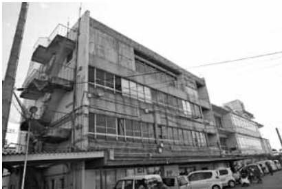
老朽化した粉河支所
