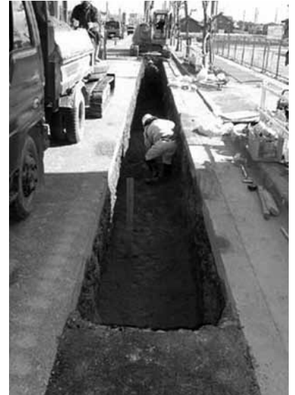
進みつつある下水道
