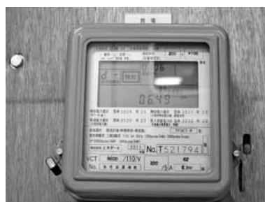
市役所本庁の電力量計
