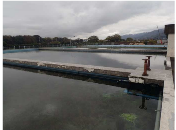
【花野浄水場 緩速ろ過池】
