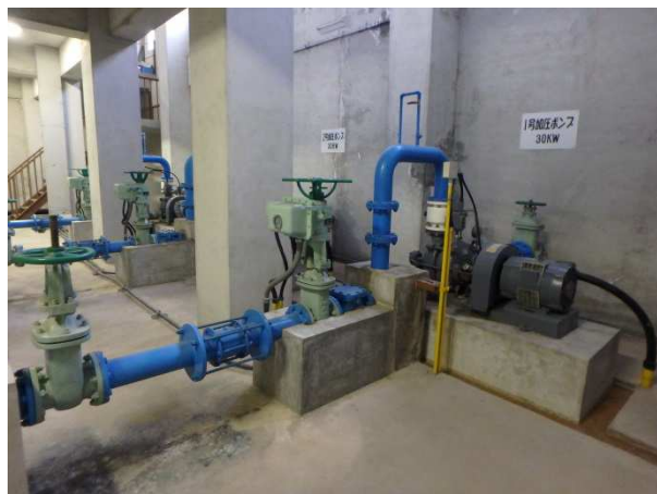
【長山加圧ポンプ所】
