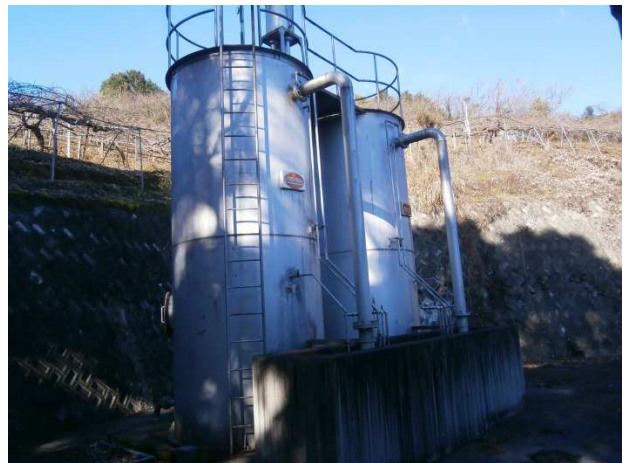
【大原浄水場 急速ろ過装置】
