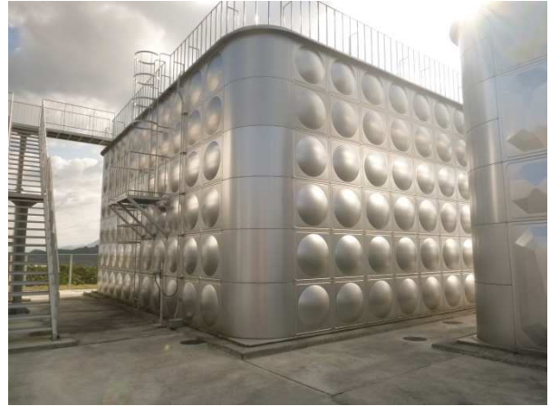
【那賀西野山配水池】
