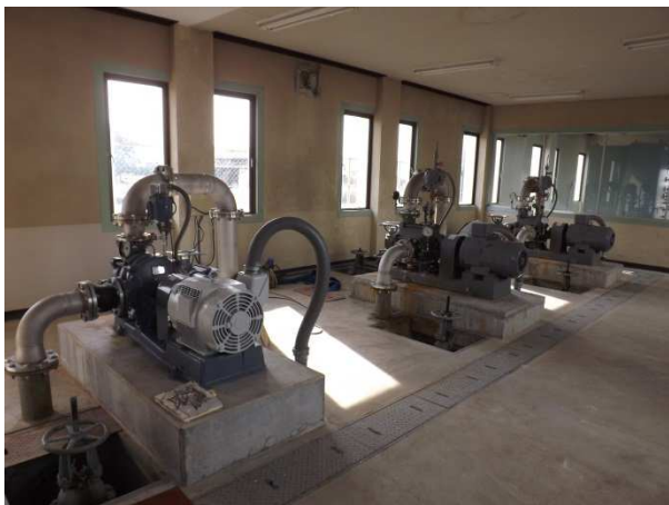
【打田第 1 配水池中継ポンプ所】
