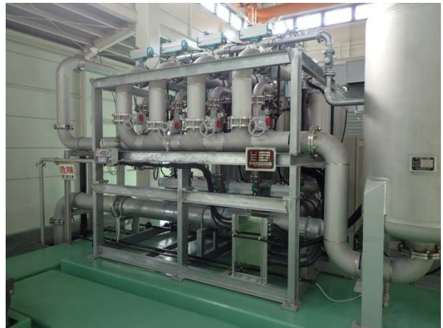
【穴伏浄水場 膜ろ過装置】
