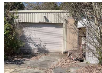
防災倉庫の老朽化
