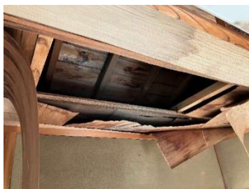
天井の剥がれ（雨漏り）
