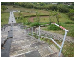
手摺階段の劣化（花見の丘）
