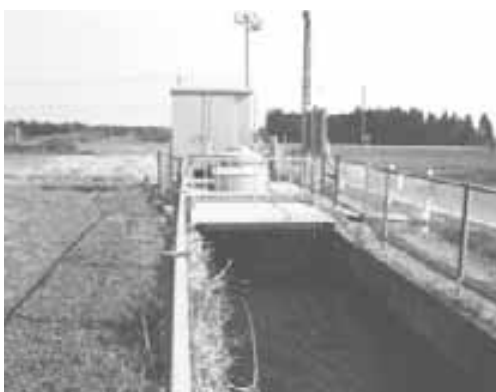
視察先の小水力発電装置
