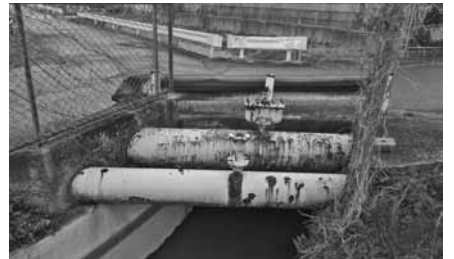
取り替えが必要な老朽管
