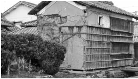
長い間放置された空き家
