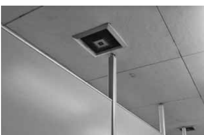
窓がないので換気扇に頼るしかない
