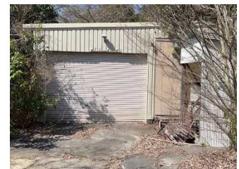
防災倉庫の老朽化
