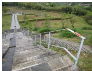
手摺階段の劣化（花見の丘）
